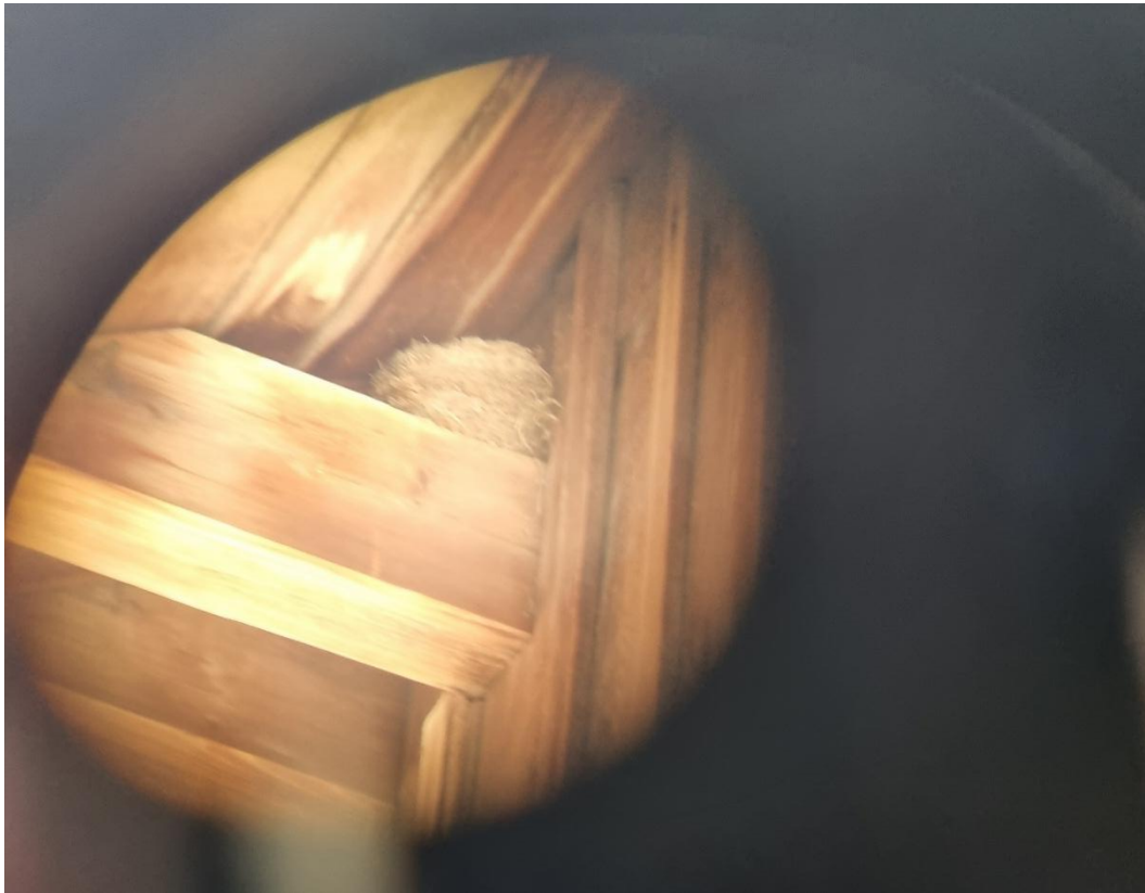
Abbildung 12: Vogelnest (vermutlich Hausrotschwanz) an einem Dachbalken an der Südfassade.
