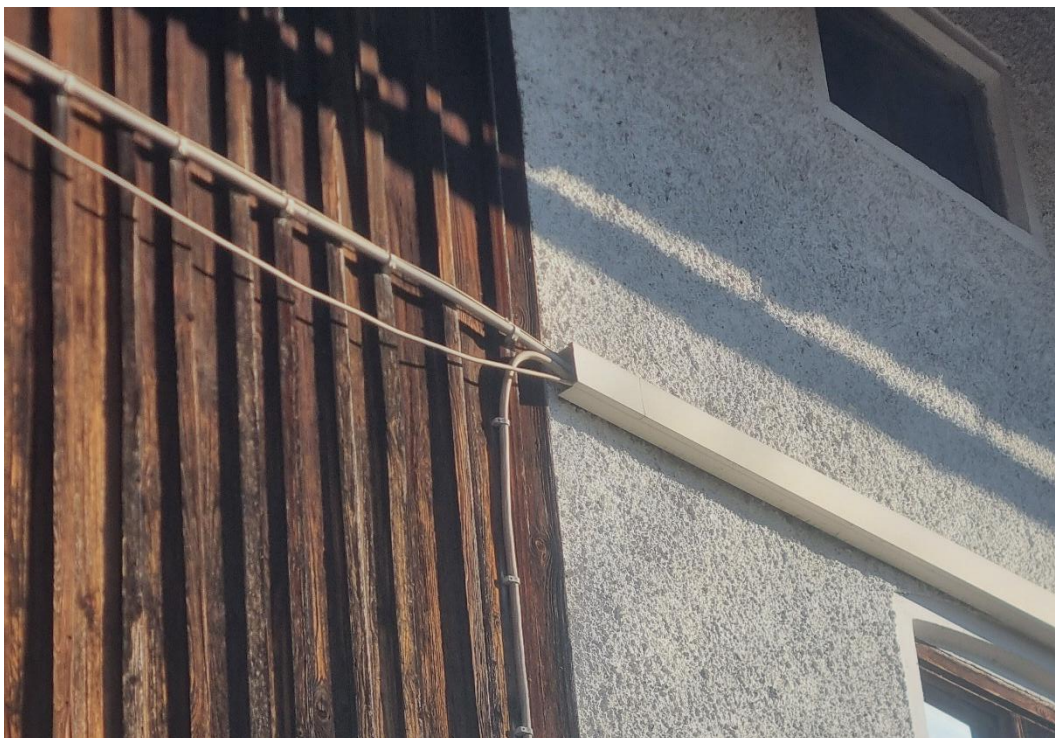
Abbildung 11: Kabelröhre an der Südfassade in die ein Einflug eines Haussperlings beobachtet wurde.
