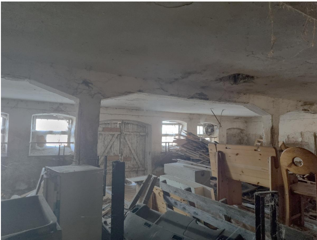
Abbildung 7: Mit Unrat und Altlasten gefülltes Untergeschoss der Scheune.
