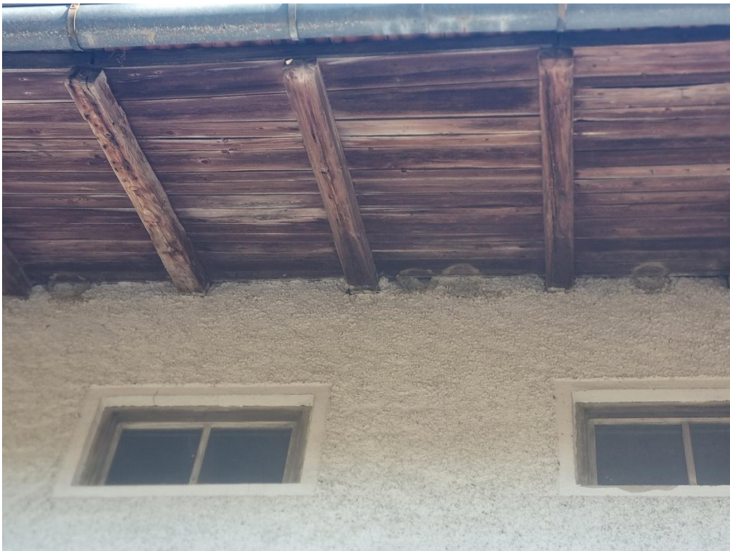
Abbildung 13: Abgeschlagene Schwalbennester an der Südfassade.
