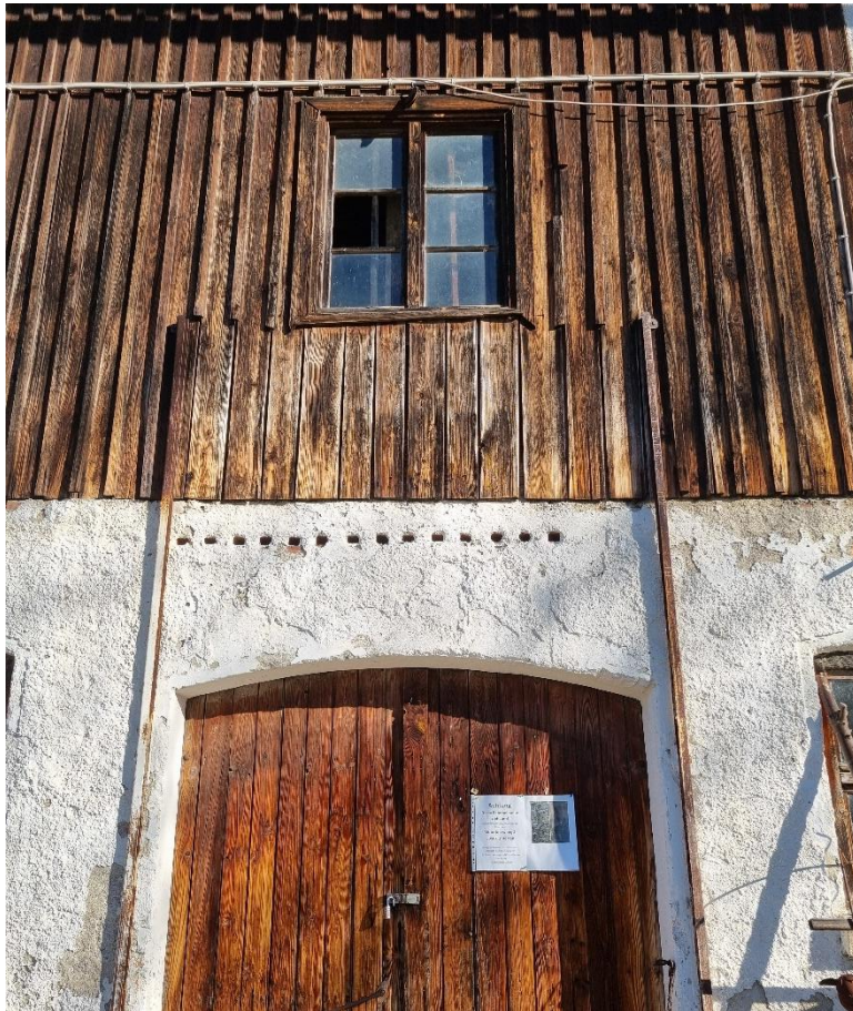
Abbildung 14: Beschädigtes Fenster und Holzverkleidung an der Südfassade des Hofes (Blickrichtung Norden).
